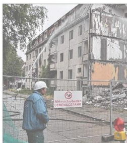
Ein Bagger schafft in der Ochsenkopfstraße 5-8 um die Wohnbaugenossenschaft Halberstadt (WGH) Platz für den 22. Neubau.
